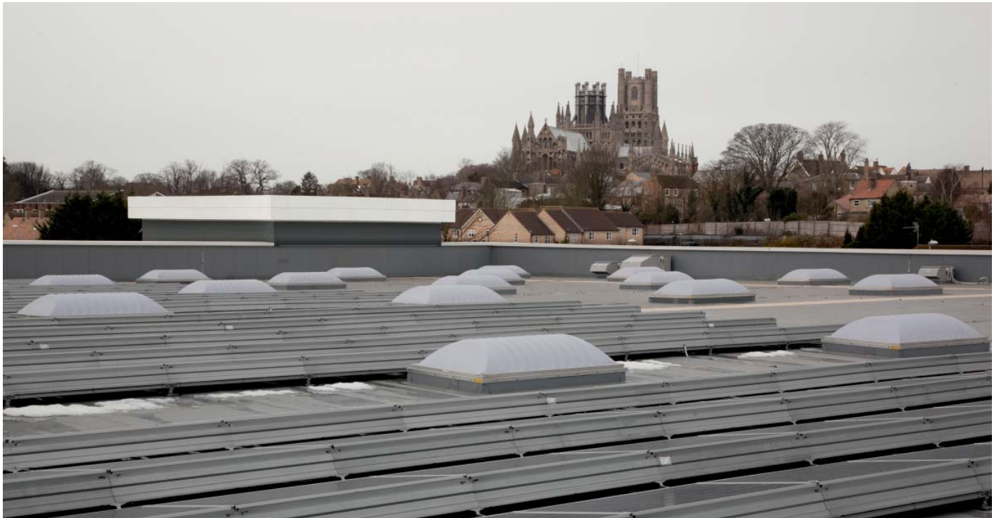
Verbrauchermarkt Sainsbury's in Leicester: Kombination von prismatischen Lichtkuppeln mit Photovoltaik (Foto: Sunoptics)
